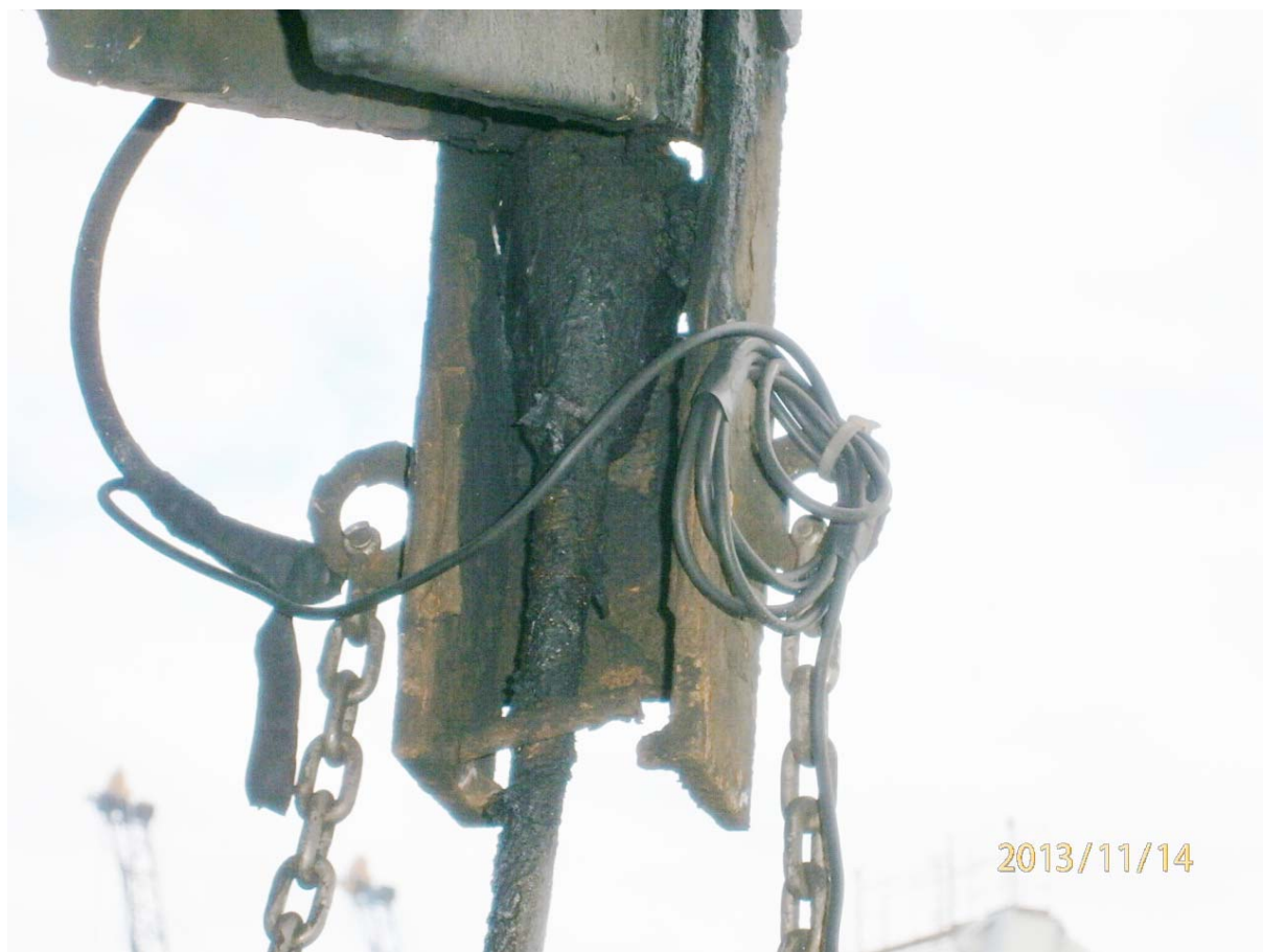
Figura 5. Estructura de protección del terminal cónico, tras el accidente
