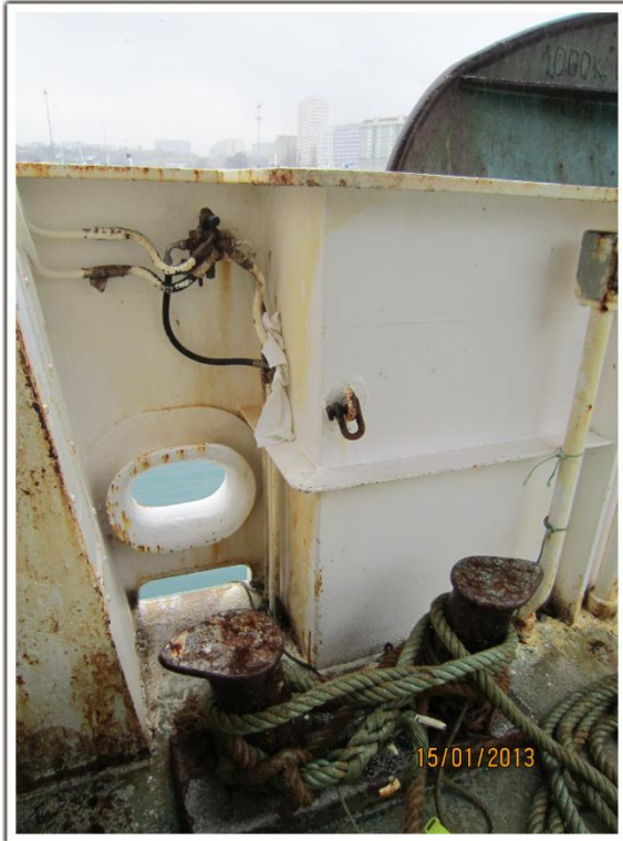
Figura 5. Elementos de amarre sobre cubierta sobre los que pudo también caer el marino accidentado.
