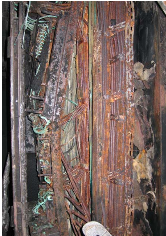
Figura 6. Aspecto del cableado afectado
