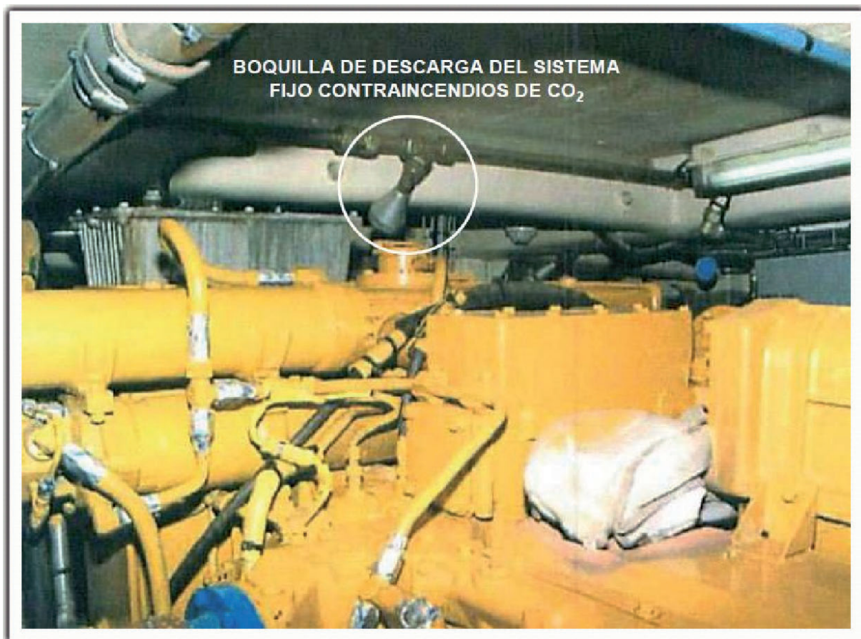
Figura 6. Disposición de una boquilla de descarga de CO 2 sobre un motor de la misma marca y modelo que el que montaba el pesquero sinistrado
