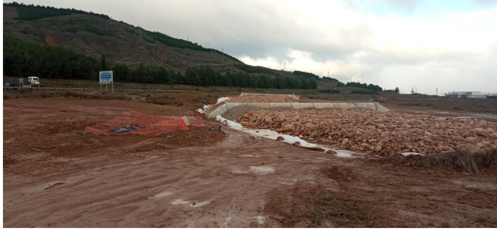
Ejecución de drenajes (Drenaje transversal y manto drenante en zona inundable junto N-232 en Arrúbal).
