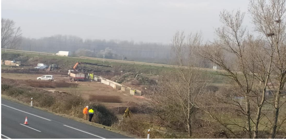
Reposición de servicios afectados (Acequia en Villamediana de Iregua en enlace LR-250).
