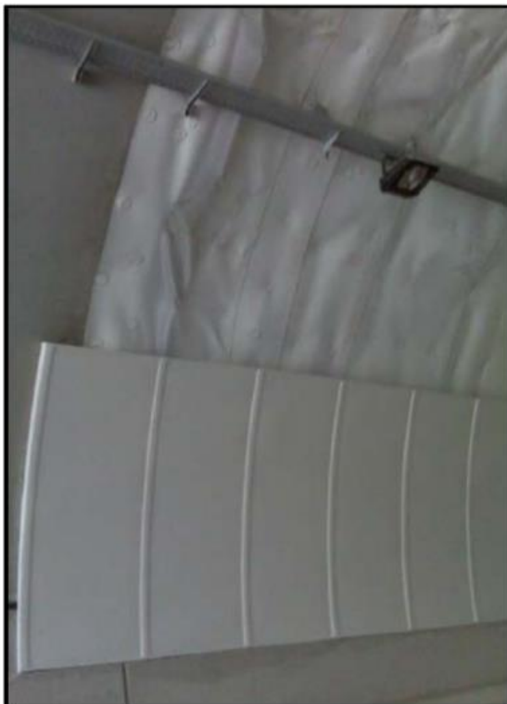
Ejemplo de resultado final tras sistema de impermeabilización en el túnel de Madroño
