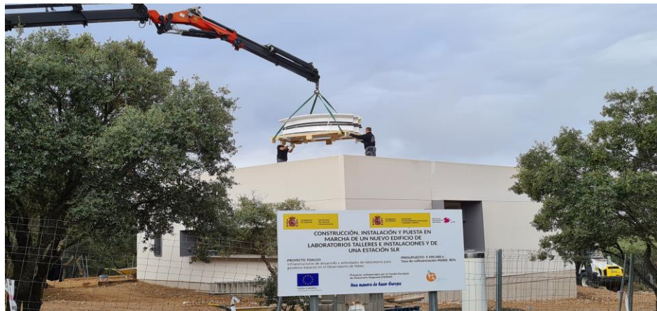
Obras de construcción de la estación SLR en el Observatorio de Yeves
