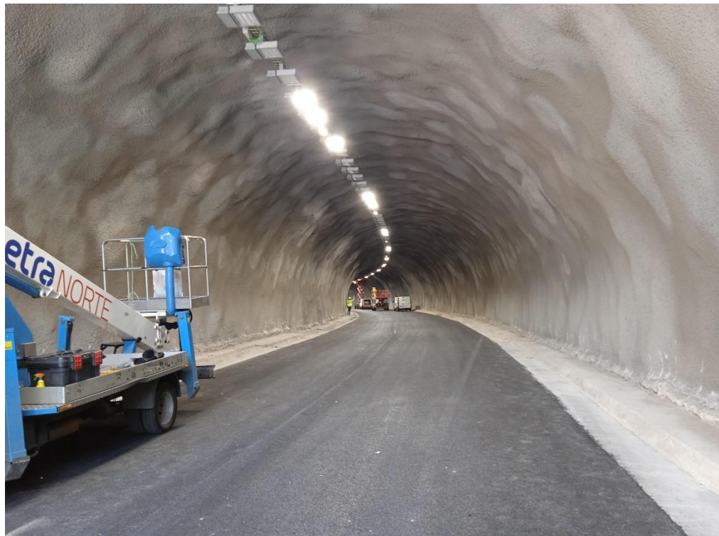
Ilustración 2. Instalación de alumbrado (157 luminarias LED)
