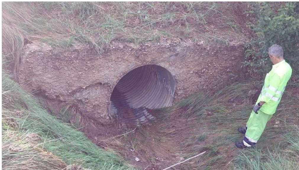
Obra de drenaje afectada
