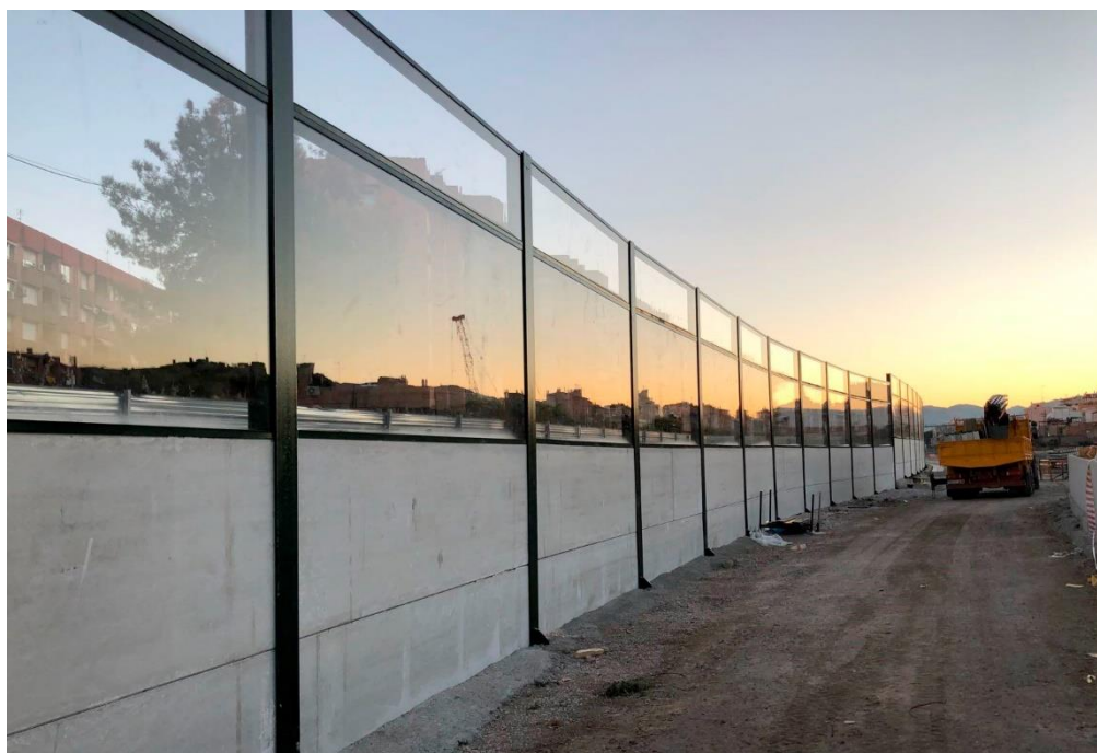
Ejemplo de instalación de mamparas antirruído en la red de alta velocidad
