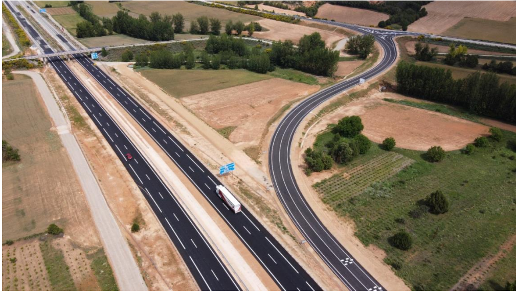
Ilustración 2. Inicio del tramo (Colindante con el tramo Variante del Burgo de Osma).
