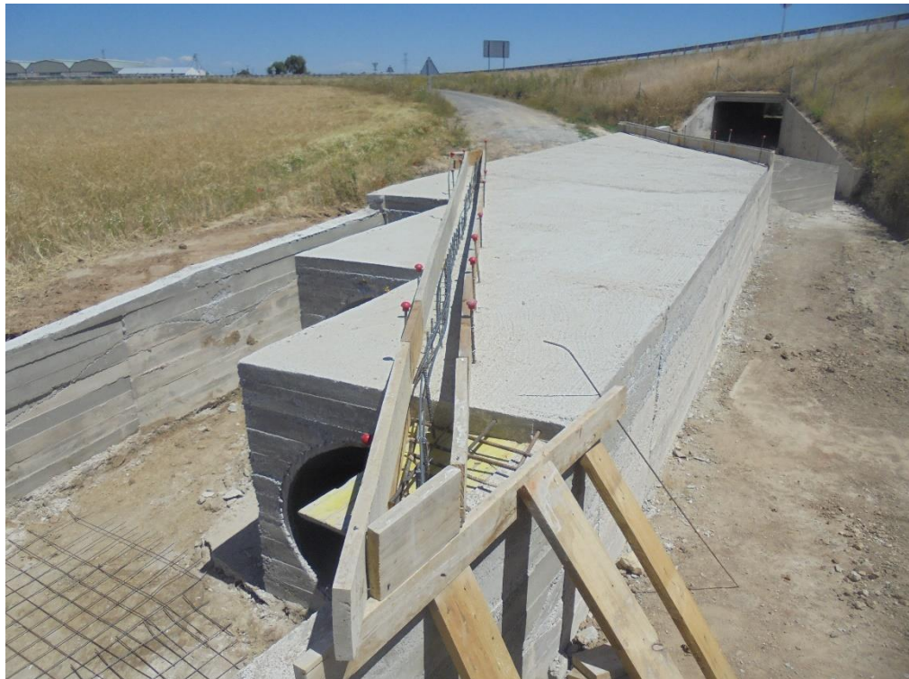
Construcción de obra de drenaje transversal y reposición de camino de servicio A-40, km 108,500
