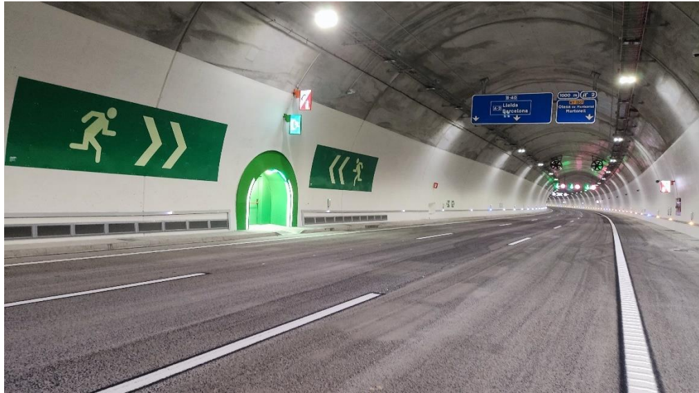
Instalaciones túnel La Voltrega
